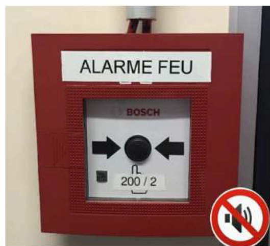
Alarme feu Fire alarm Feuer Alarm
