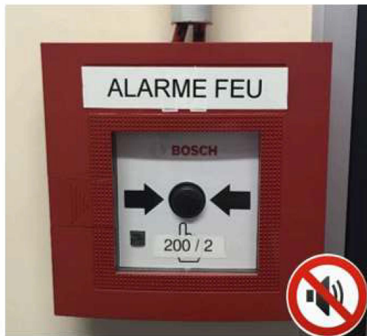
Alarme feu Fire alarm Feuer Alarm
