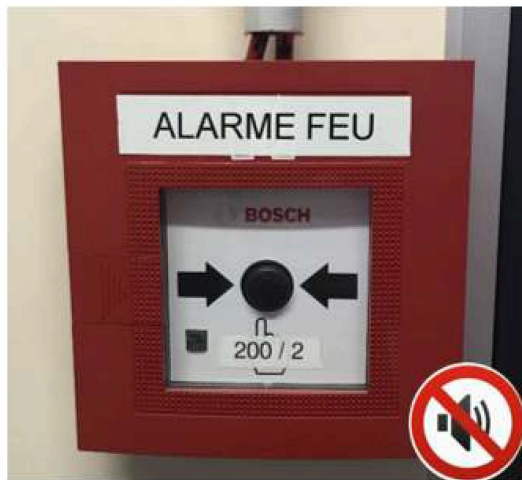
Alarme feu Fire alarm Feuer Alarm
