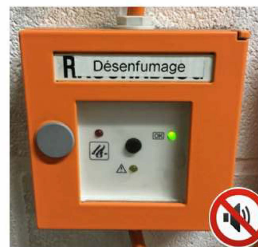
Activation du système de désenfumage Activation of the smoke extraction system Aktivierung des Rauchabzug
