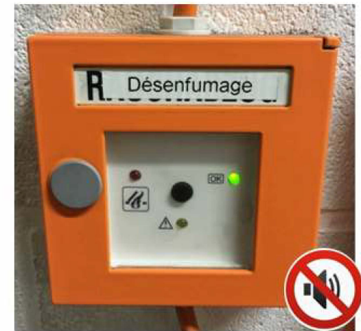
Activation du système de désenfumage Activation of the smoke extraction system Aktivierung des Rauchabzug
